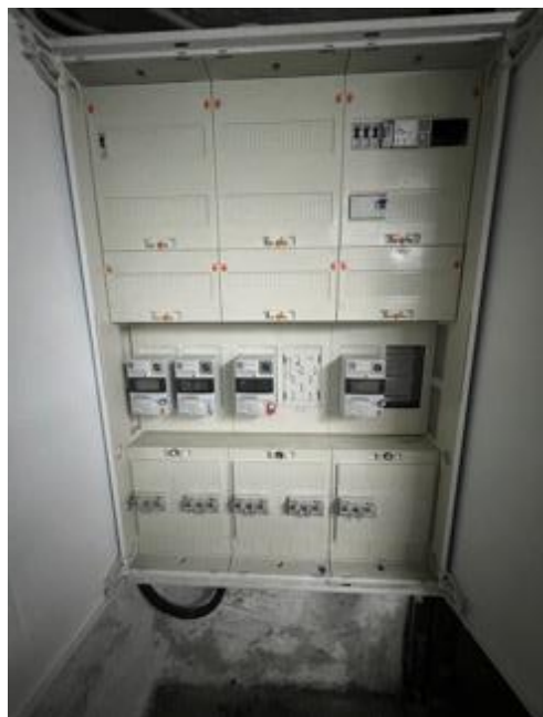
Ansicht: Stromkasten (neu/2012)
